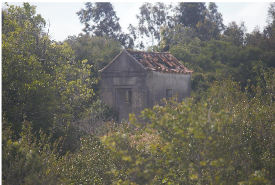
Figura 29. Avançada degradação dos prédios. Foto da autora, 2020.
