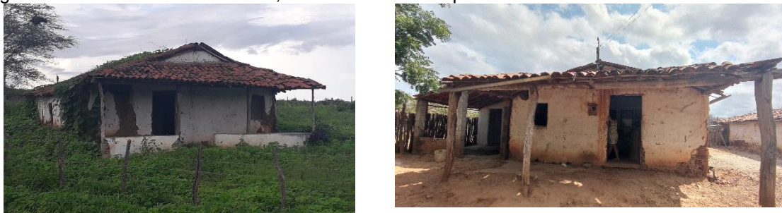
Figura 65: Casas em arruinação, PS010 e VN023 respectivamente.
