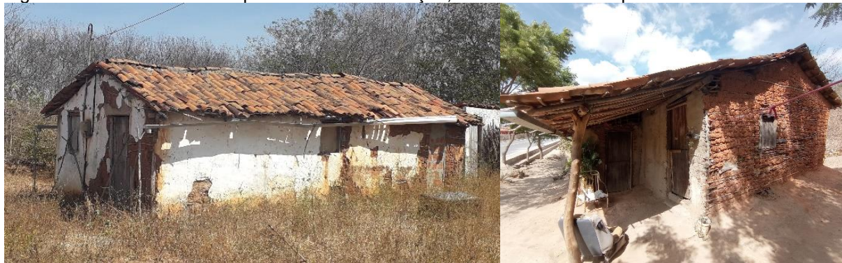
Figura 64: Casas em estado precário de conservação, PS013 e EN042 respectivamente.
