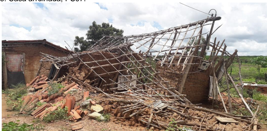
Figura 66: Casa arruinada, PS07.
