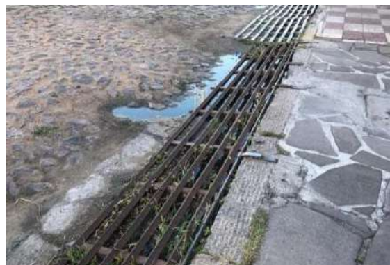
Figura 4.27: Rampa de metal com buracos e água acumulada na rua General Teles em Pelotas. Fonte: Autor, 2020.
