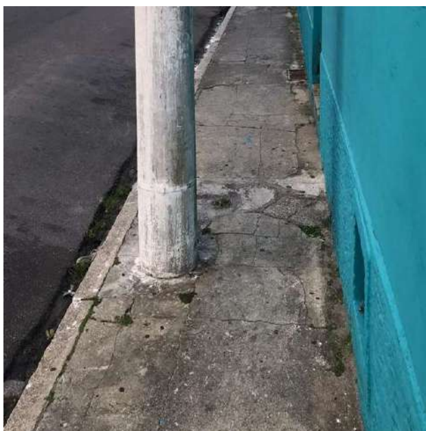
Figura 4.32: Poste de transmissão de energia ocupando 1/3 do passeio, no trecho da rua Santa Cruz, na cidade de Pelotas. Fonte: Autor, 2019.
