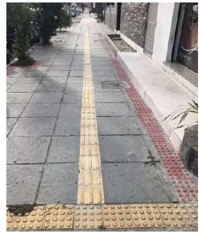
Figura 4.5: Piso tátil mal planejado na rua Padre Felício em Pelotas. Fonte: Autor, 2020.
