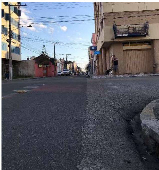
Figura 4.36 - Sinalização da ciclofaixa desgastada, no trecho da rua Felix da Cunha, na cidade de Pelotas. Fonte: Autor, 2019.
