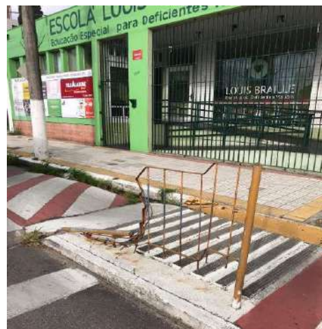
Figura 4.7: Grade de proteção danificada da rua Andrade Neves em Pelotas. Fonte: Autor, 2020.
