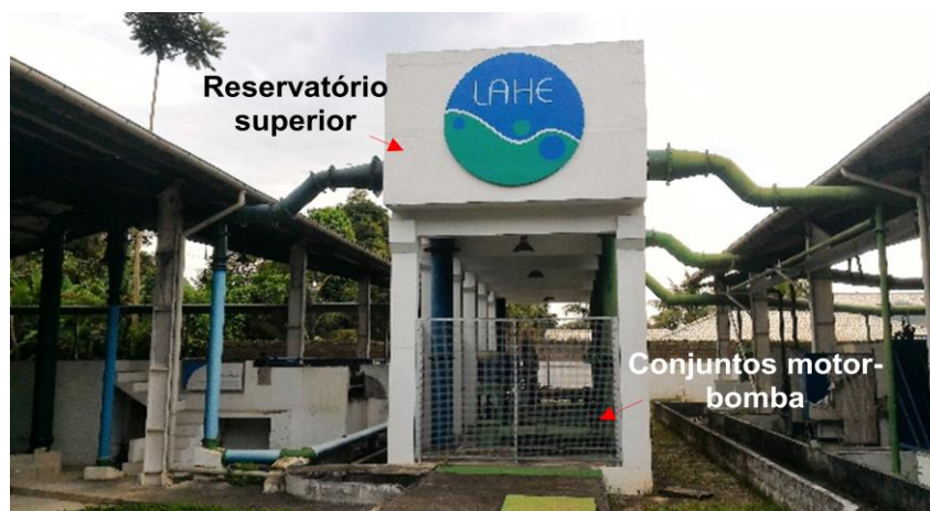
Figura 9 - Vista do reservatório superior e da casa de bomba do modelo LAHE.
