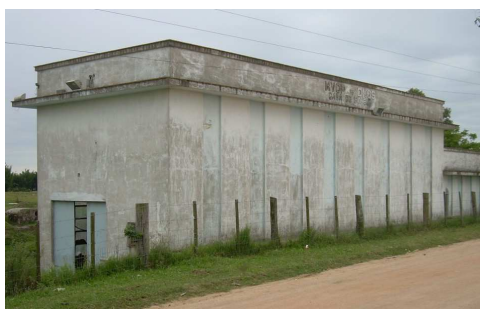
Figura 15: Casa de Bombas Leste. Pelotas. RS. Fonte: Foto do autor, 2012.
