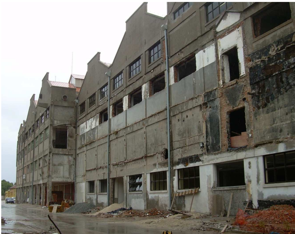
Figura 19: Frigorífico Anglo, grandes alterações na estrutura do edifício. Pelotas. RS.
