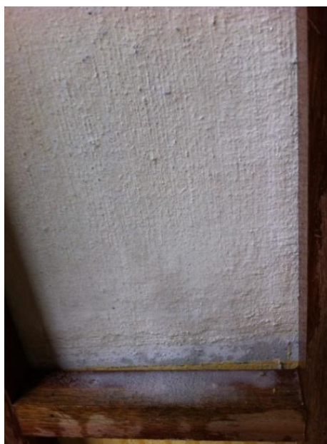
Figura 46 - Água com resíduo na superfície pintada com cal e óleo de linhaça. Fonte: acervo da autora (março de 2012).
