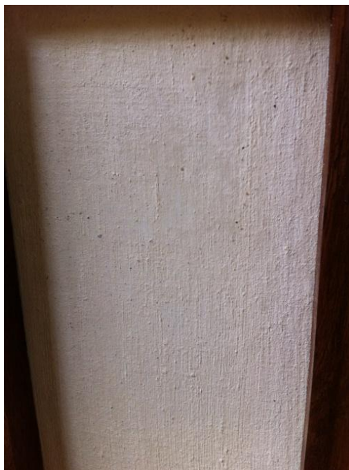
Figura 48 - Detalhe do resultado na área de aplicação da tinta a cal com óleo de linhaça após a aplicação do teste de abrasão.
