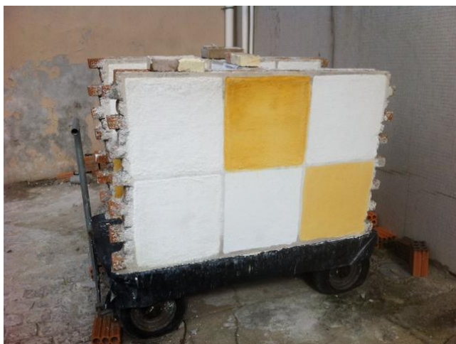
Figura 57 – Alvenaria-H com manchas ocasionadas pela umidade da água da chuva. Fonte: acervo da autora (dezembro de 2012).
