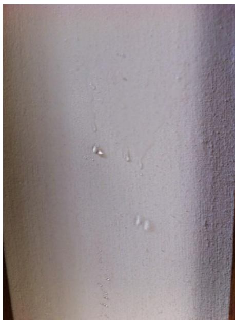
Figura 45 - Detalhe das gotículas na superfície pintada com cal e óleo de linhaça. Fonte: acervo da autora (março de 2012).
