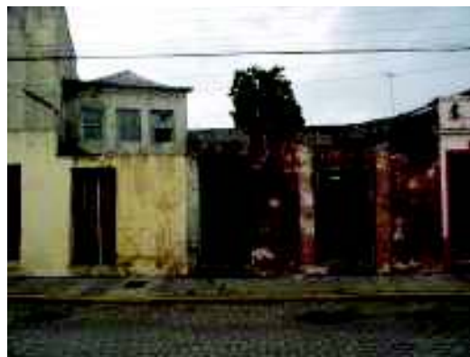
Figura 4.5: Prédio em mau estado de conservação na Rua 1 (Fonte: Acervo da autora, 2011)
