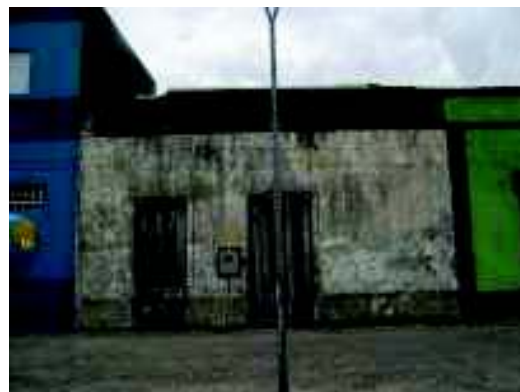
Figura 4.3: Prédio em mau estado de conservação na Rua 3.(Fonte: Acervo da autora, 2011)
