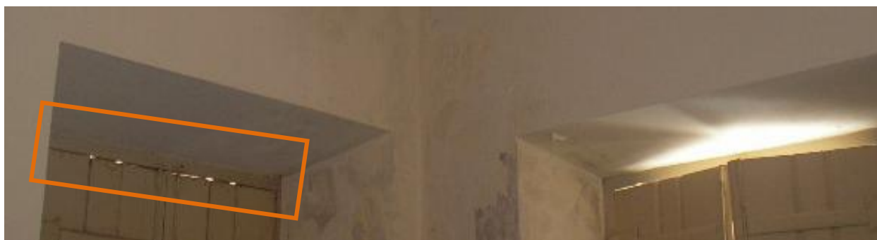
Figura 37 - fendas das esquadrias
