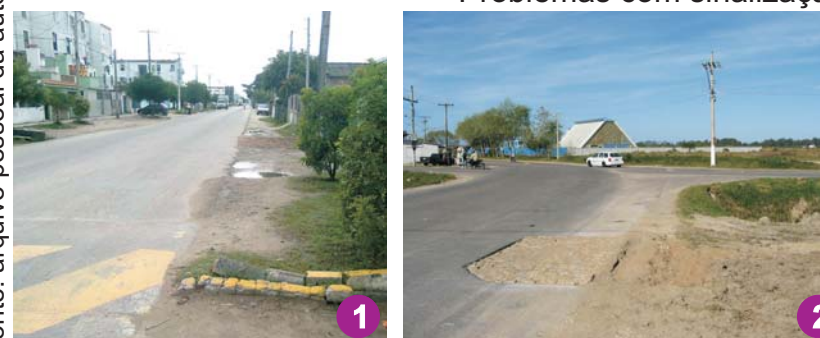
Problemas com pavimentação
