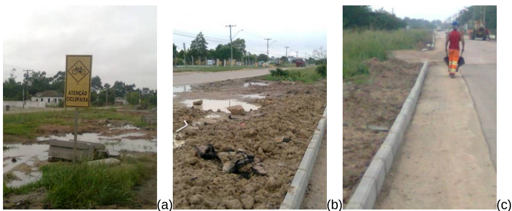
Figura 154. Principais problemas apontados pelos ciclistas na ciclofaixa da Avenida Domingos José de Almeida. a) sinalização deficiente, b e c) obras de revitalização da Avenida Fernando Osório. Fonte: arquivo pessoal da autora, 2011.
