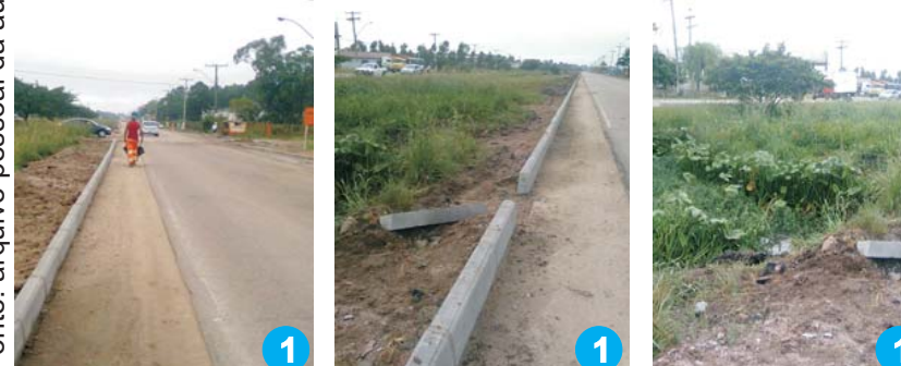
Problemas com pavimentação e drenagem
