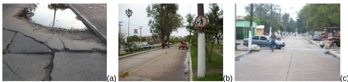
Figura 108. Problemas encontrados na Ciclovía Av. Duque de Caxias: a) pavimentação com problemas, b) compartilhamento e c) desrespeito nos cruzamentos. Fonte: arquivo pessoal da autora, 2011.
