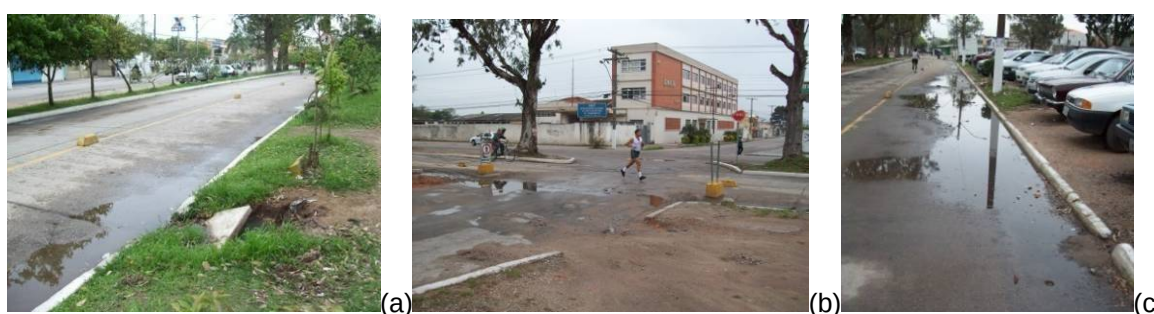
Figura 90. Ciclovia da Avenida Duque de Caxias. a) drenagem deficiente através de boca de lobos; b) falta de sinalização nos cruzamentos; c) problemas de drenagem. Fonte: arquivo pessoal da autora, 2011.
