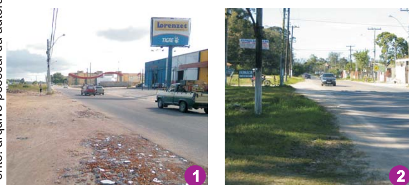
Problemas com pavimentação
