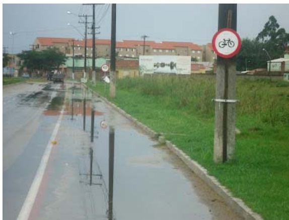
Figura 213. Problemas de drenagem na Ciclofaixa da Avenida Ferreira Viana.
