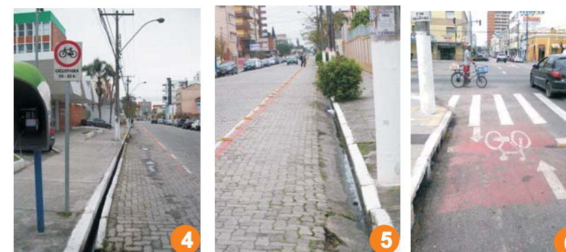
Problemas com sinalização
