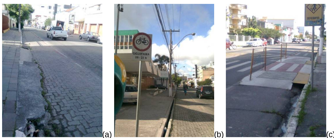
Figura 198. Ciclofaixa da Rua Andrade Neves. a) pavimentação com problemas; b) sinalização vertical; c) sinalização diferenciada em frente a uma escola de deficientes visuais. Fonte: arquivo pessoal da autora, 2012.
