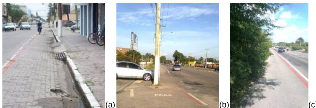
Figura 50. Elementos que reduzem o gabarito das ciclofaixas. (a) Ciclofaixa Rua Andrade Neves (problemas com rampas e sarjeta), (b) Ciclofaixa Av. Adolfo Fetter (inserção de poste de iluminação pública) e (c) Ciclofaixa Av. Adolfo Fetter (falta de manutenção com a vegetação). Fonte: Arquivo pessoal da autora, 2011.
