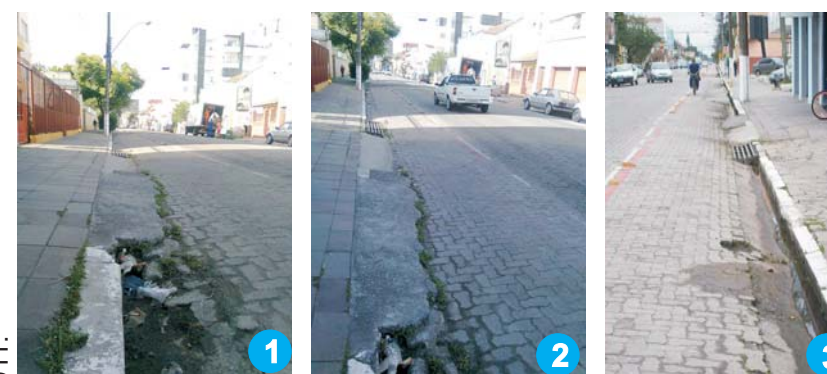
Problemas com Drenagem
