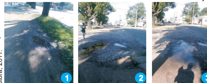
Problemas com drenagem
