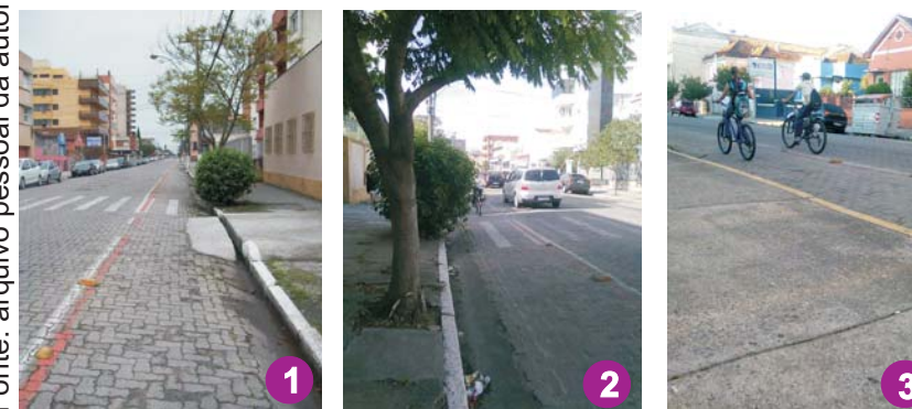
Problemas com Pavimentação
