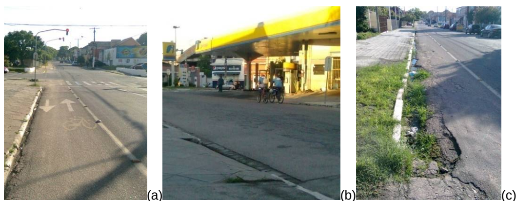
Figura 143. Problemas apontados pelos ciclistas na ciclofaixa da Av. Domingos José de Almeida. a) sinalização no final da via e b) entrada e saída de veículos e c) Problemas com drenagem e pavimentação. Fonte: arquivo pessoal da autora, 2011.
