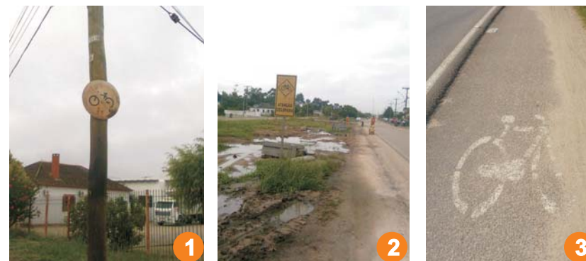
Problemas com sinalização
