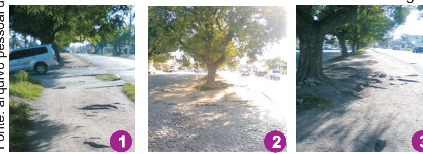
Problemas com pavimentação
