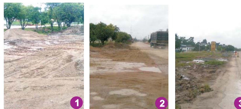
Problemas com pavimentação
