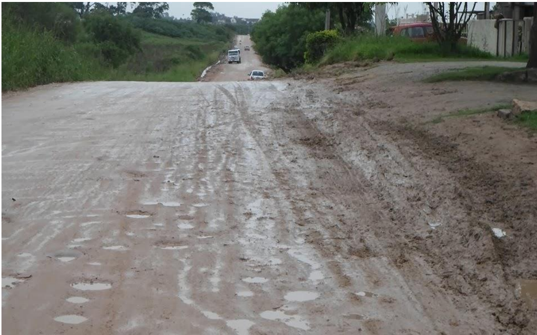
Figura 38- Como era a Rua João Jacob Bainy antes dos investimentos públicos do PAC2
