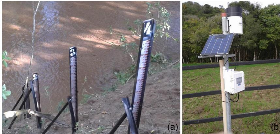
Figura 21 - Réguas linimétricas instaladas (a) e estação hidrológica (b) instaladas junto à seção de controle da BHACN.
