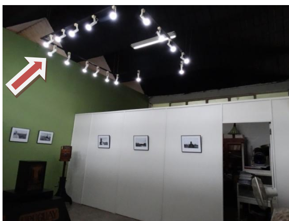
Figura 65 – Antiga sala de exposição, agora, reserva técnica visitável com o sistema de iluminação artificial utilizando lâmpadas LED's. Foto: Taciane Souza, 2015.
