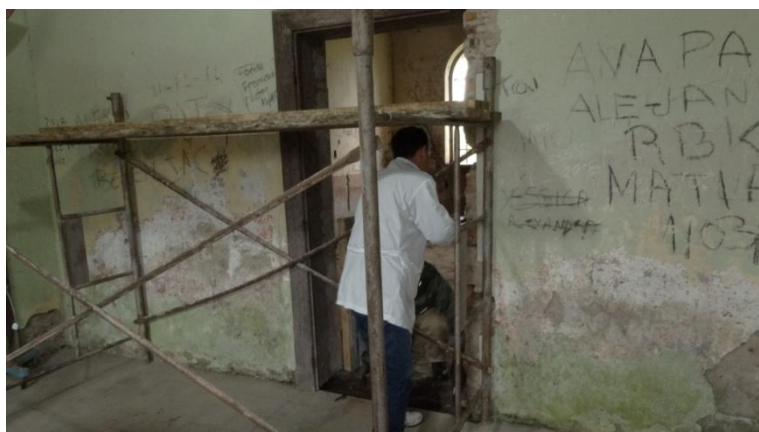
Figura 28 – Parede P4 com pichações, vandalismo.
