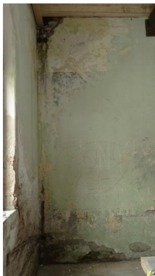
Figura 27 – Da esquerda para direita parede P2 e P3, perda de reboco, pintura, manchas de umidade.
