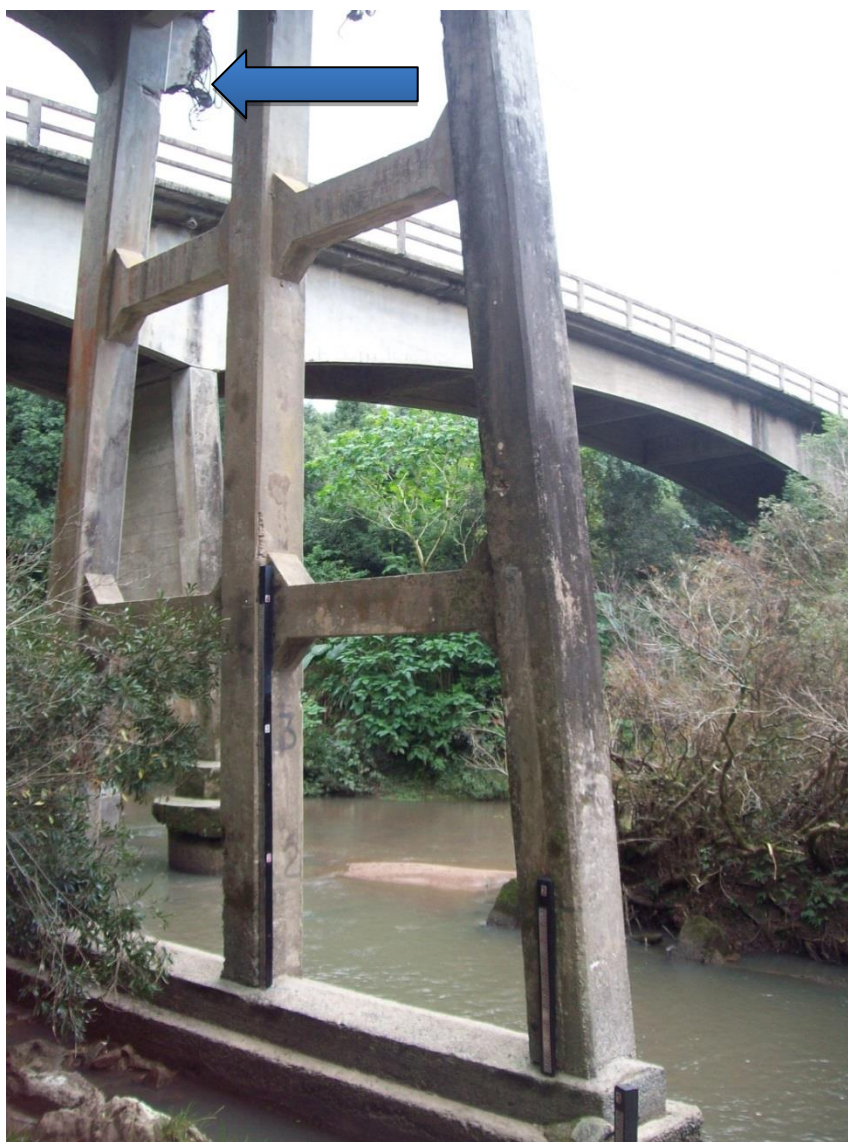
Figura 44: Marca da altura da água na enxurrada de 2009 - Ponte sobre o Arroio Pelotas, próximo a foz do Arroio Quilombo Fonte: RUTZ (2015)
