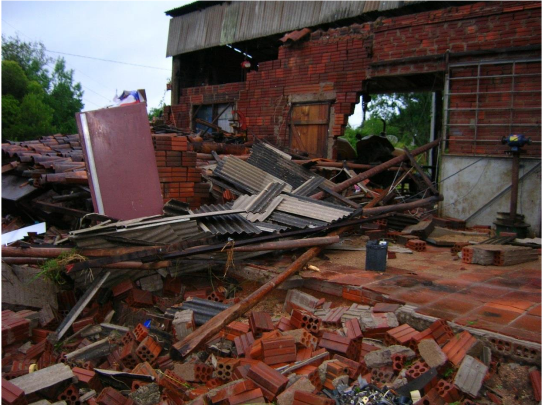
Figura 28: Galpão destruído em consequências da enxurrada de janeiro de 2009 Fonte: Moradora Elisia Vergara Herrmann (2009)
