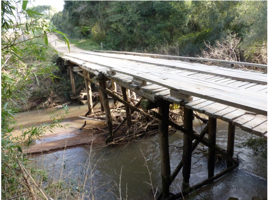
Figura 42: Ponte sobre o Arroio Quilombo (Baixa Bacia). Observa-se o acúmulo de restos vegetais trazidos pelo arroio presos na base da ponte. Fonte: RUTZ (2015)
