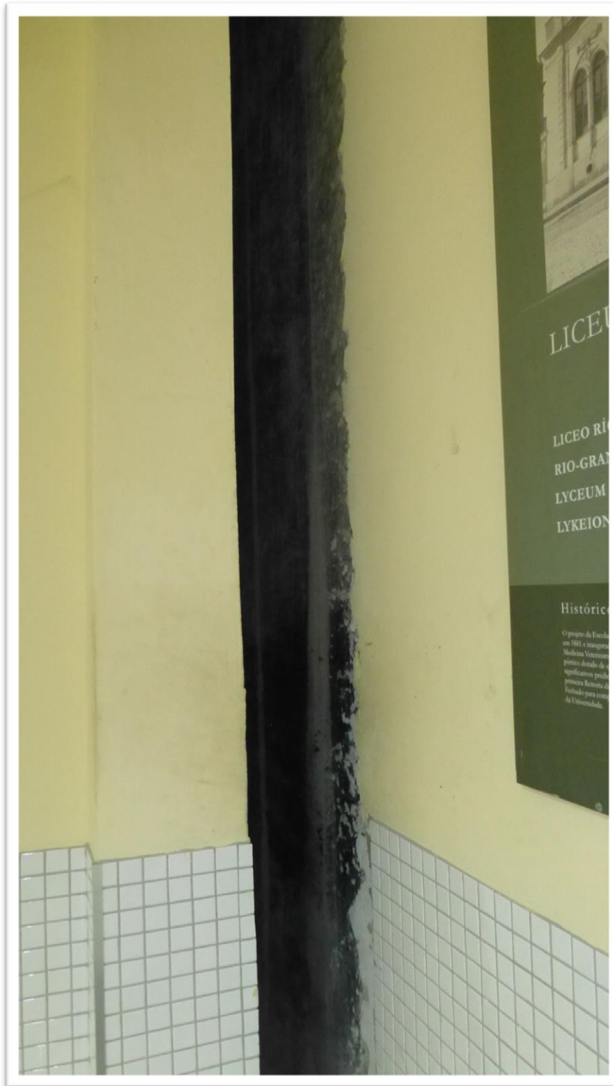
Figura 11 - Fenda nas paredes do Bloco A, Frigorífico Anglo de Pelotas, RS
