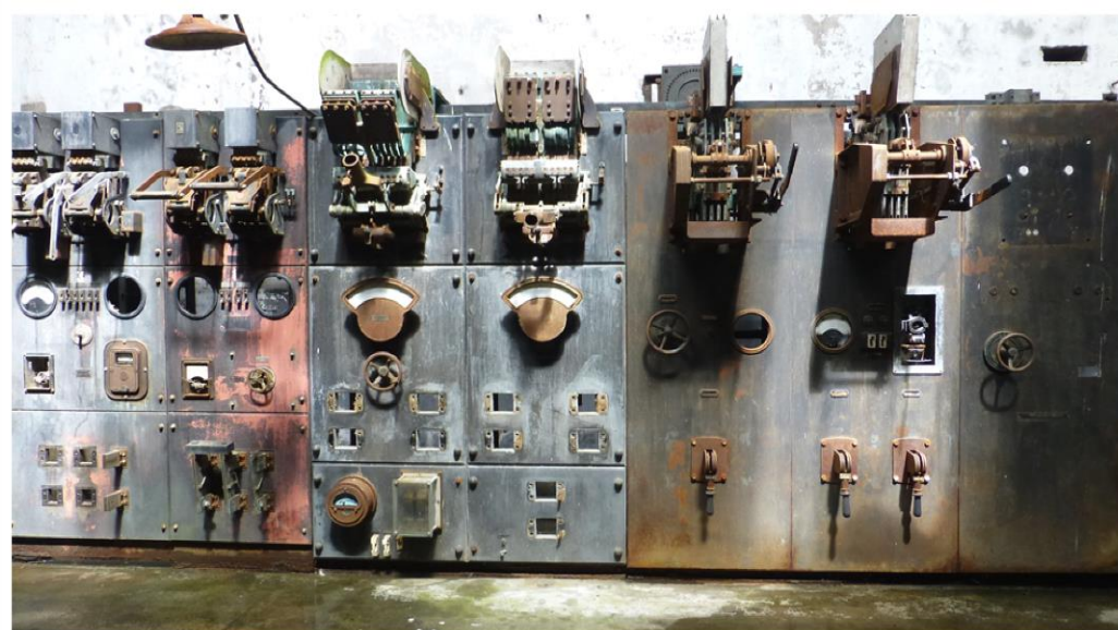
Sala de geração de energia, Fray Bentos, Uruguay
