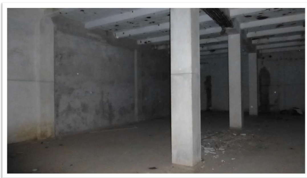
Extintas câmaras frias, Pelotas, RS
