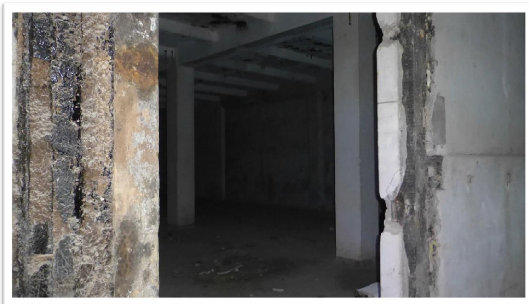
Figura 13 – Interior de uma câmara fria, Frigorífico Anglo de Pelotas, RS
