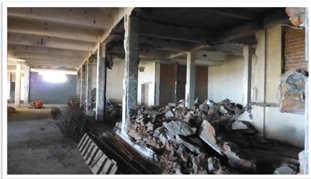
Figura 17 – Paredes quebradas nas câmaras frias, Frigorífico Anglo de Pelotas, RS
