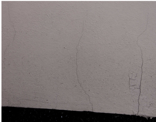
Figura 3 – Fissuras verticais sobre a viga de fundação.
