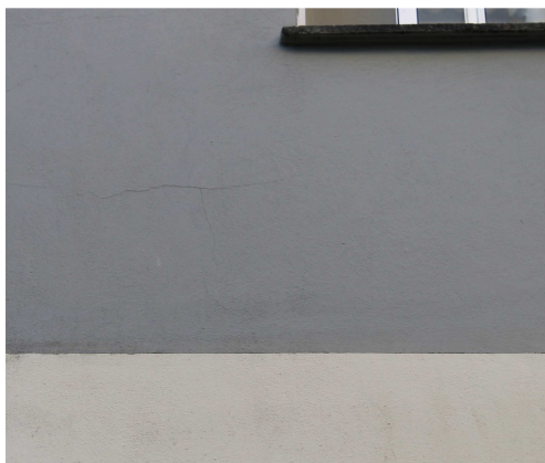
Figura 1 – Fissuras horizontais e verticais no revestimento.
