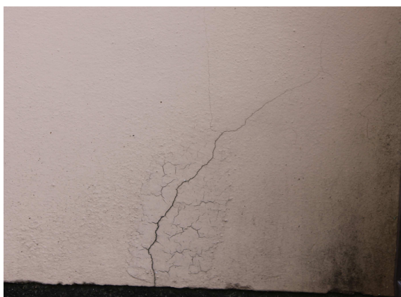
Figura 5 – Trinca inclinada próxima a viga de fundação.
