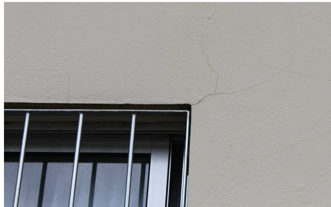
Figura 4 – Fissuras inclinadas no canto superior da janela.
