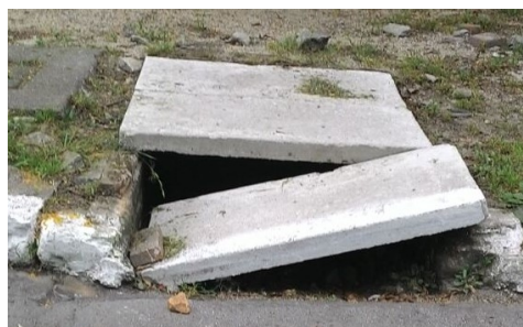
Figura 3: Boca de lobo danificada. Fonte: O autor.
