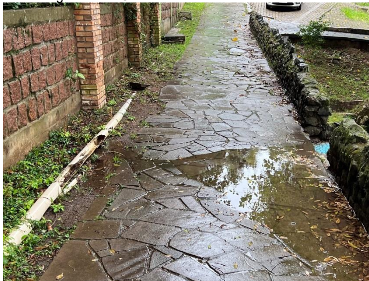
Figura 111 - Cano danificado acima da Fonte
