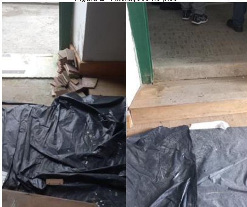
Figura 2 - Alterações no piso
