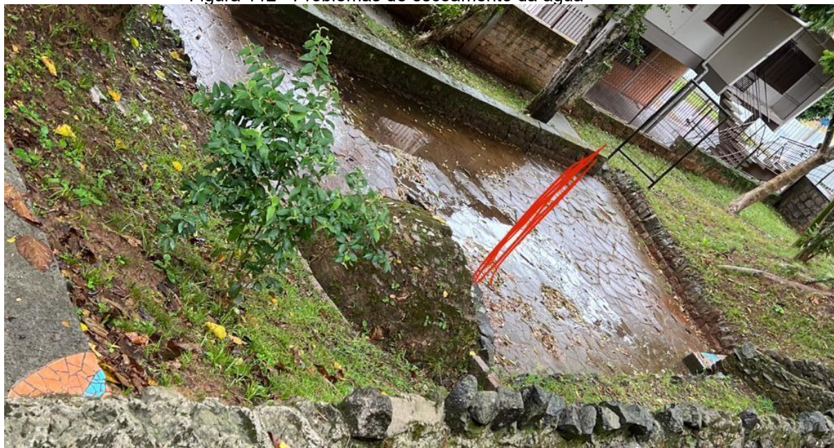
Figura 112 - Problemas de escoamento da água
