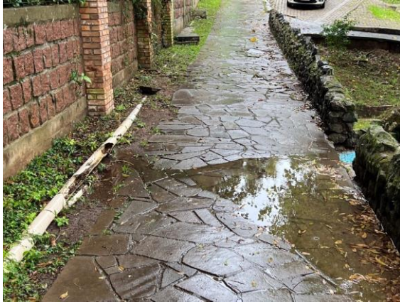
Figura 111 - Cano danificado acima da Fonte
