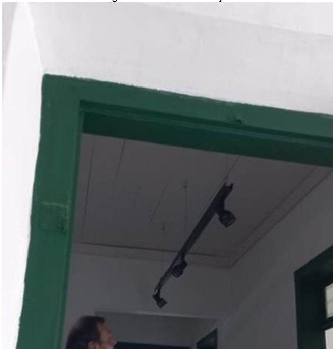
Figura 3 - Trilhos de iluminação
