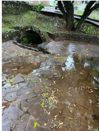
Figura 114 - Acúmulo de água no basalto irregular
