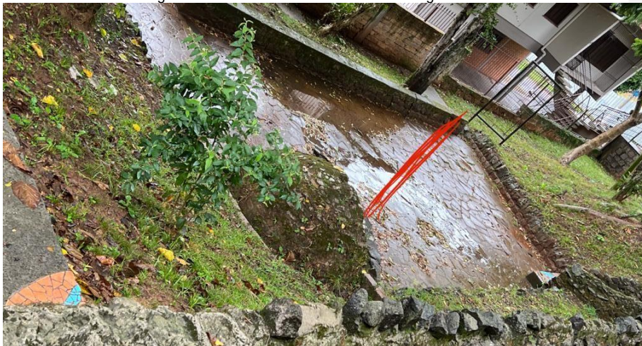
Figura 112 - Problemas de escoamento da água
