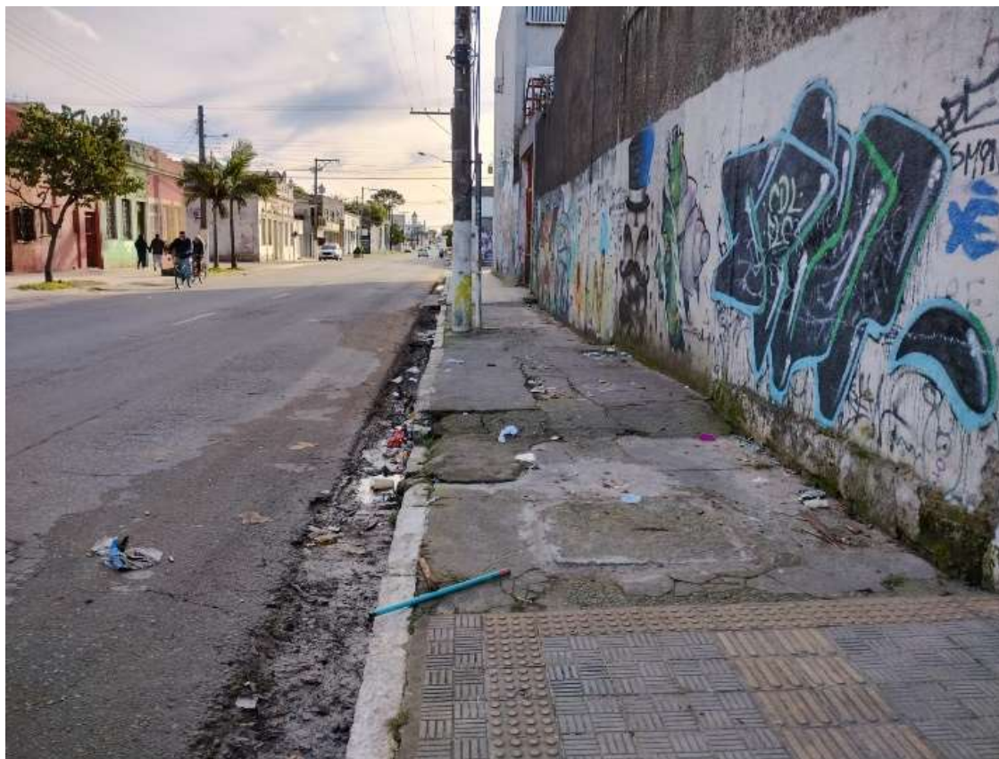
Figura 49 – Guia tátil em apenas um trecho da calçada na rua Conde de Porto Alegre. Fonte: ACERVO DA AUTORA, 2023.
