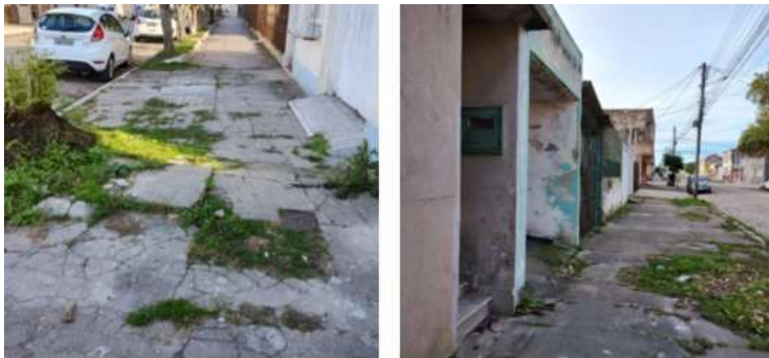
Figura 57 – Calçadas sem manutenção: Rua Dona Mariana. Fonte: ACERVO DA AUTORA, 2023.
