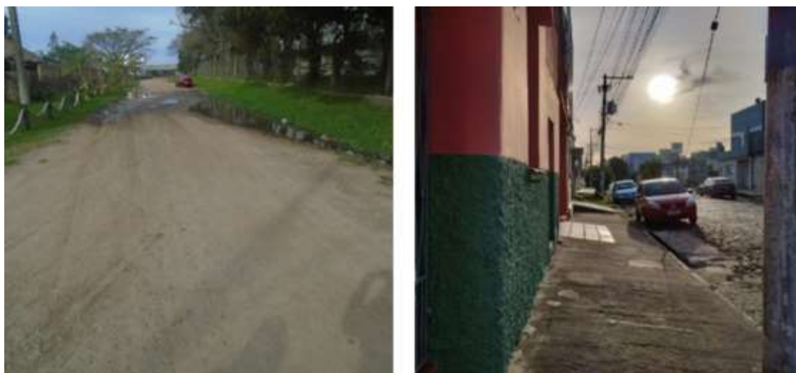
Figura 56 – Rua sem pavimentação no Quadrado e Calçada com diversos desníveis na rua Uruguai.
