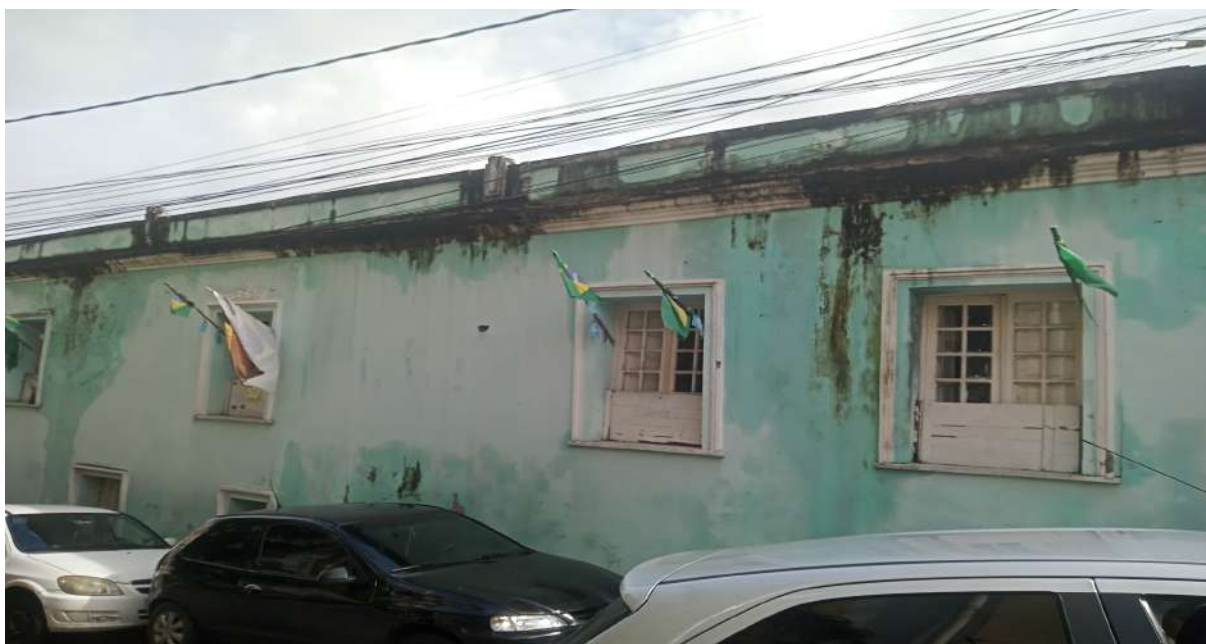
Figura 8 - 9 Edifícios reformados em estado de degradação.
